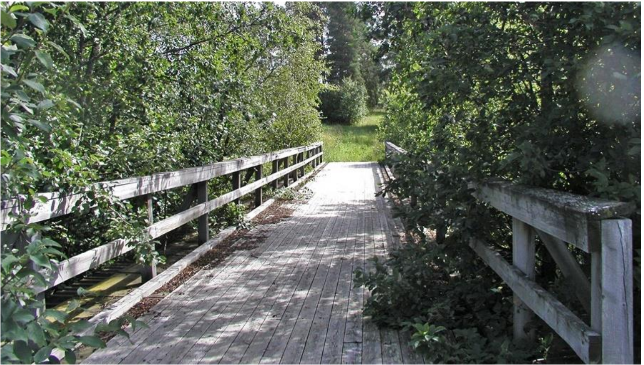
Gula bron som den såg ut den 3 augusti 2010. Den gula färgen har flagnat av. Bortom bron kan Bruksådungen skymtas. I dag ägs bron och terrängen öster om den av Nipfrakt i Sollefteå AB. I dag är bron avstängd med stora plank och får ej beträdas. Foto S-O Braff.
